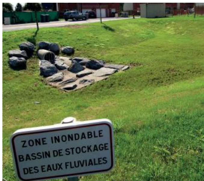
Bassin sec enherbé – rue de Carpentras, Sequedin
